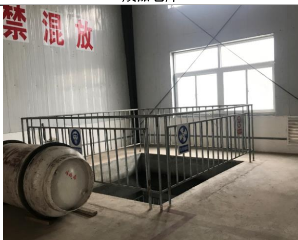
硫化氢房内应急碱池
